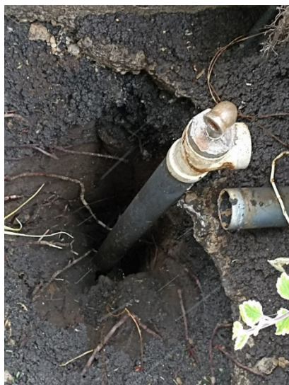
Foto No. 5. Vista de la tubería deshabilitada (pz-11-0069).
